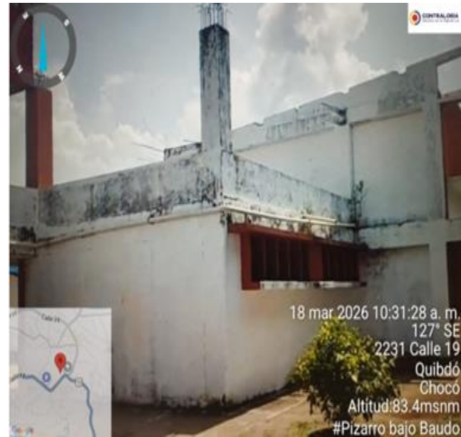
Imagen 6 Bajo Baudó Pizarro sin construcción y no esta adecuado el espacio actualmente para el Co-laboratorios, no se encuentran instalados los equipos tecnológicos y suministros.
